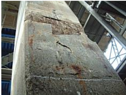
鉄筋の腐食によるコンクリート剥離状況
